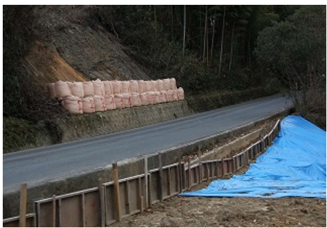
農免道路 谷田 土砂崩れ
