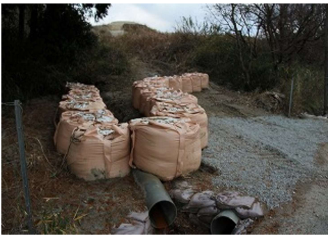
兵庫 道路に土砂流出
